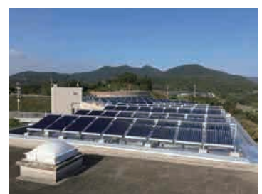
老健施設へ導入した太陽熱利用設備
