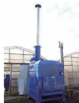
バイオマスボイラー
