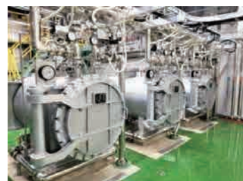
ジュースヒーター(圧力容器)
