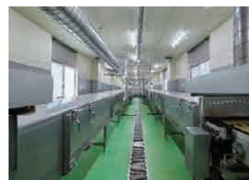
長さ約90メートルの蒸しライン
