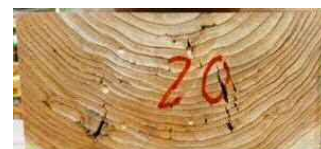
図7 平角材の内部割れ
