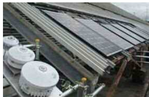
図4 屋上に設置したモジュール
