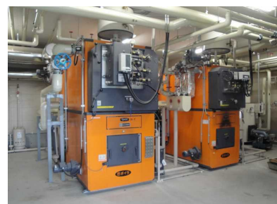
図1 バイオマスボイラー
