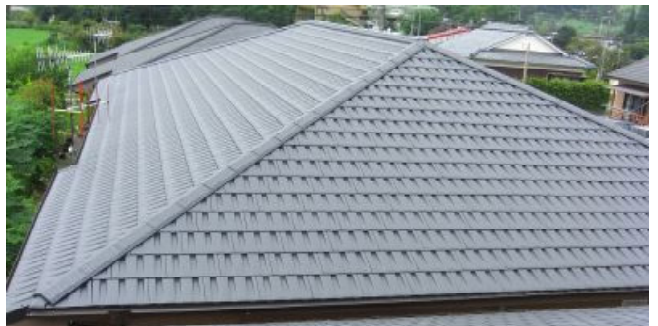
図 17 シラス瓦 新築屋根工事 石娘 S-24 薩摩郡さつま町 Z 邸
