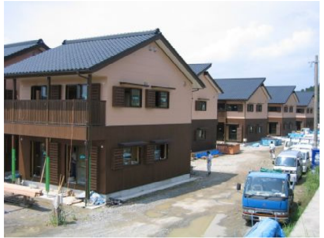
図 16 シラス瓦 新築屋根工事 和瓦防災タイプ 鹿児島市 松陽台団地
