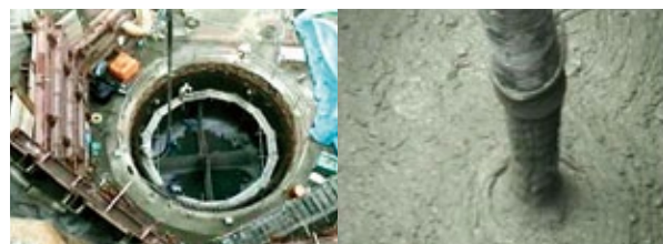
写真-5 温泉環境橋脚基礎へのシラスコンクリートの施工状況
